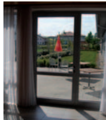
Beispiel: Nicht prominent positionierter, kaum erkennbarer und nicht HBW-adäquater Gartenausgang.
