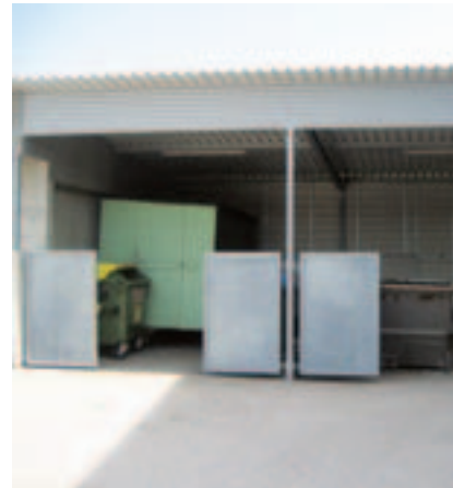
Beispiel: Überdachter Müll- und Lagerplatz
